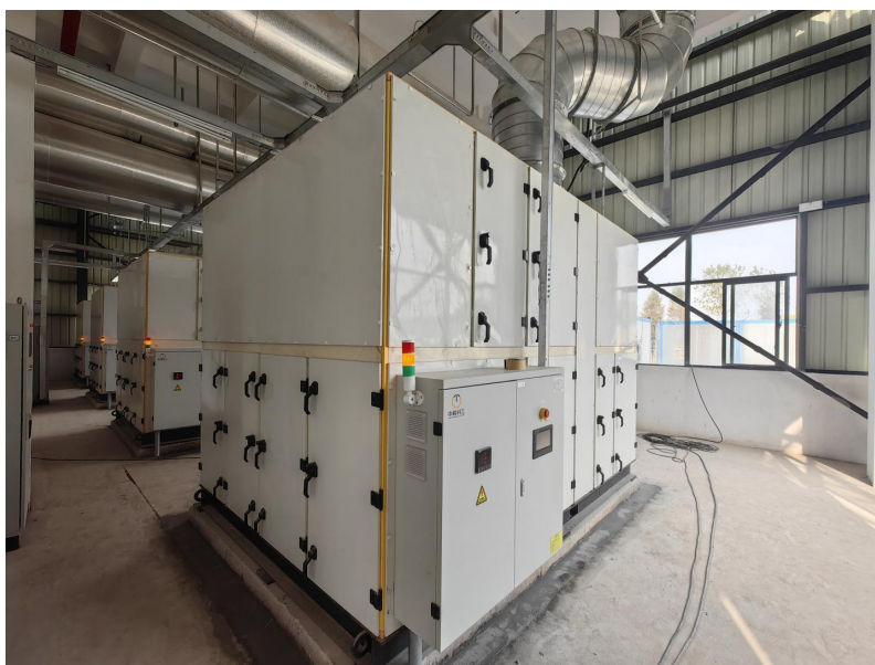
项目示范点现场照片
