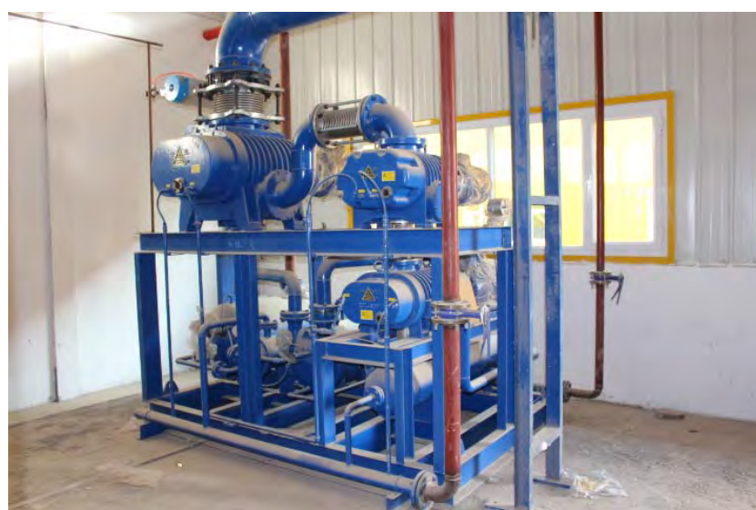
干式冷凝真空系统应用现场之二
