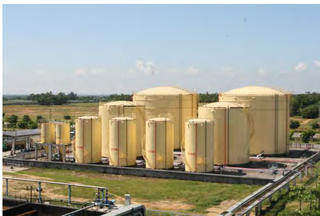
图4 成品酒精罐区
