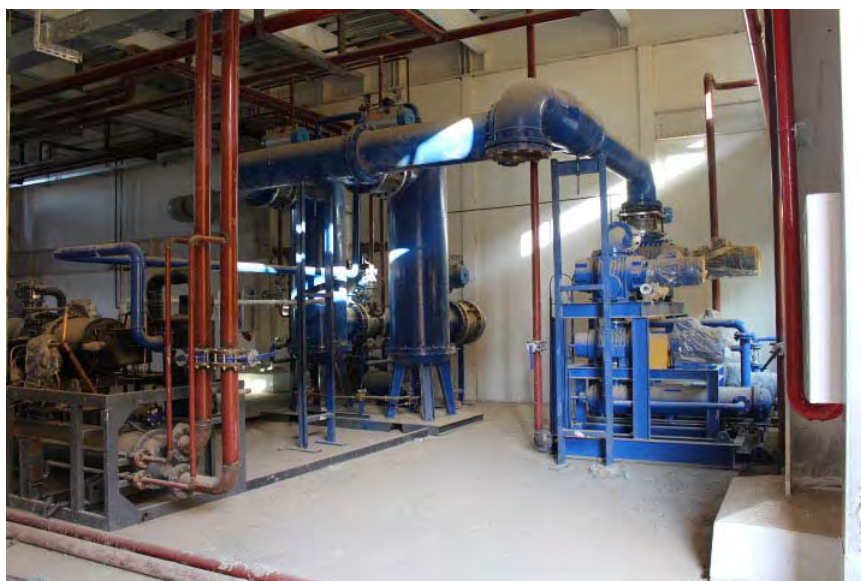
干式冷凝真空系统应用现场之一
