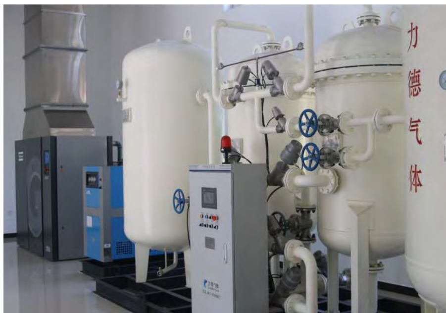
图 2 氮气气调储粮制氮设备
