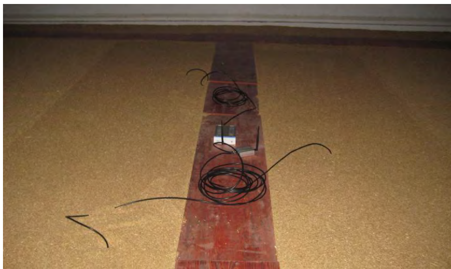
粮堆密度测量系统安装现场
